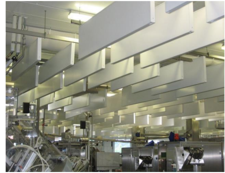
Lärmschutzbaffeln in der Produktion
