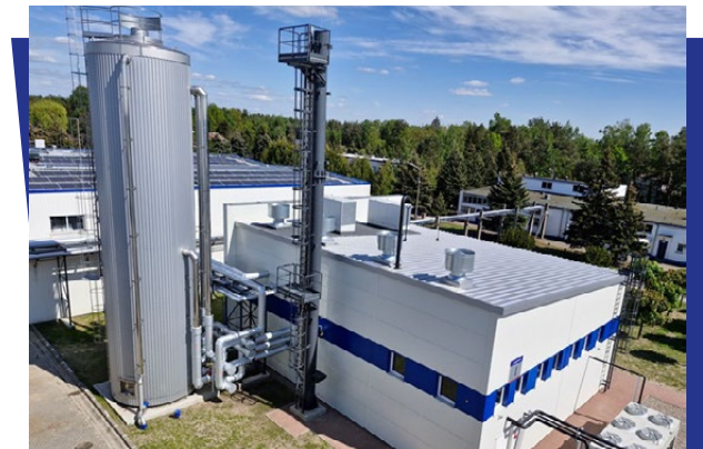
Fot. Kogeneracja Zakład Węgrów
